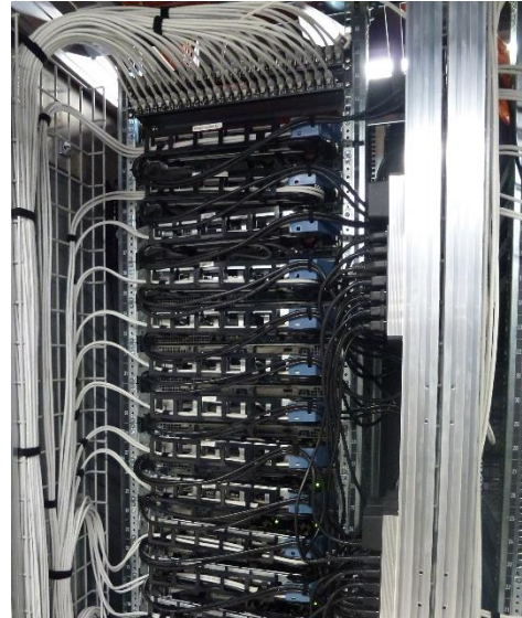
Strukturierte „Top Of Rack“ Serververkabelung
