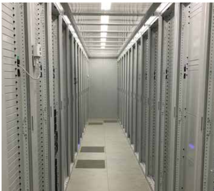
Massgeschneiderte CCM-Verkabelung für das neue Tier-III-Rechenzentrum der Atos AG.
